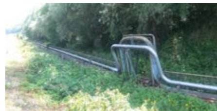
Energetski vod Jesenice-Bela je potreben vzdrževalnih del
